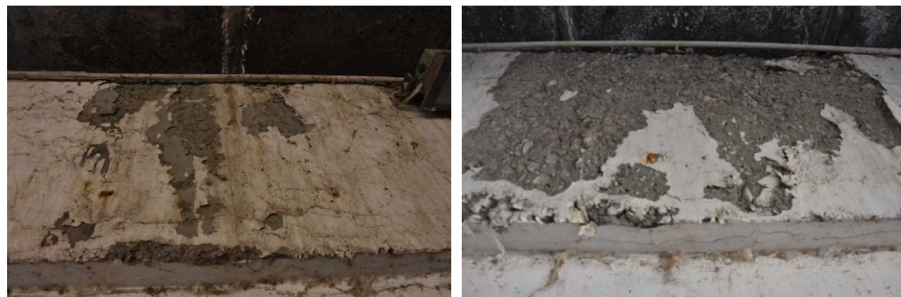
图 3.2.1 桥台台帽渗水典型照片
