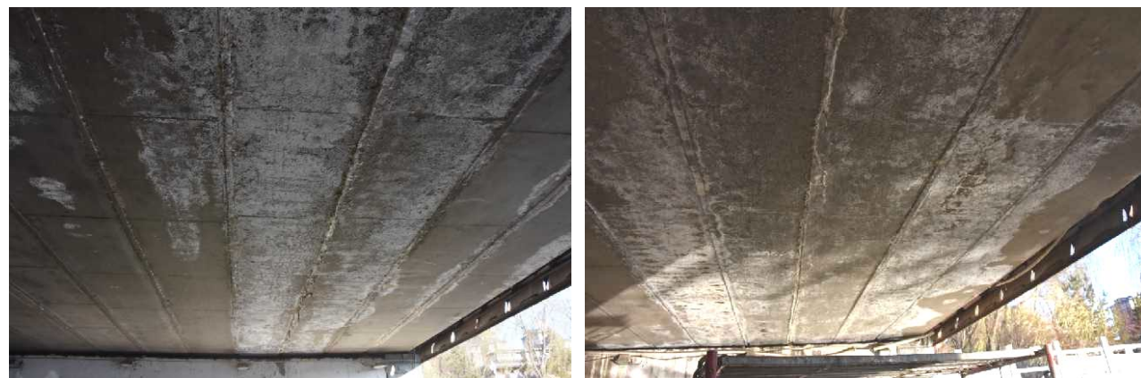
图 3.1.4 主梁梁底泛白典型照片
