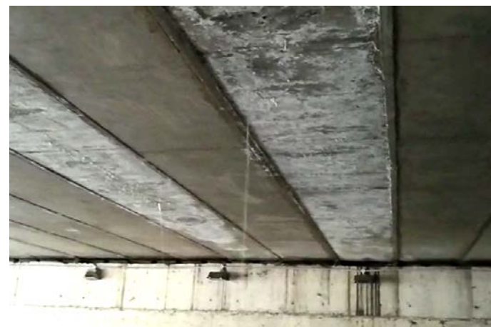
图 3.1.2 空心板梁空腔内积水
