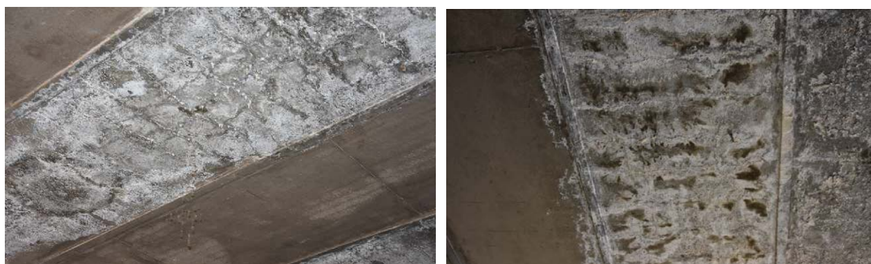
图 3.1.1 上部结构主梁正弯矩裂缝典型照片
