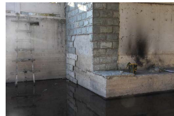
图 3.2.3 桥台外包饰面砖脱落典型照片
