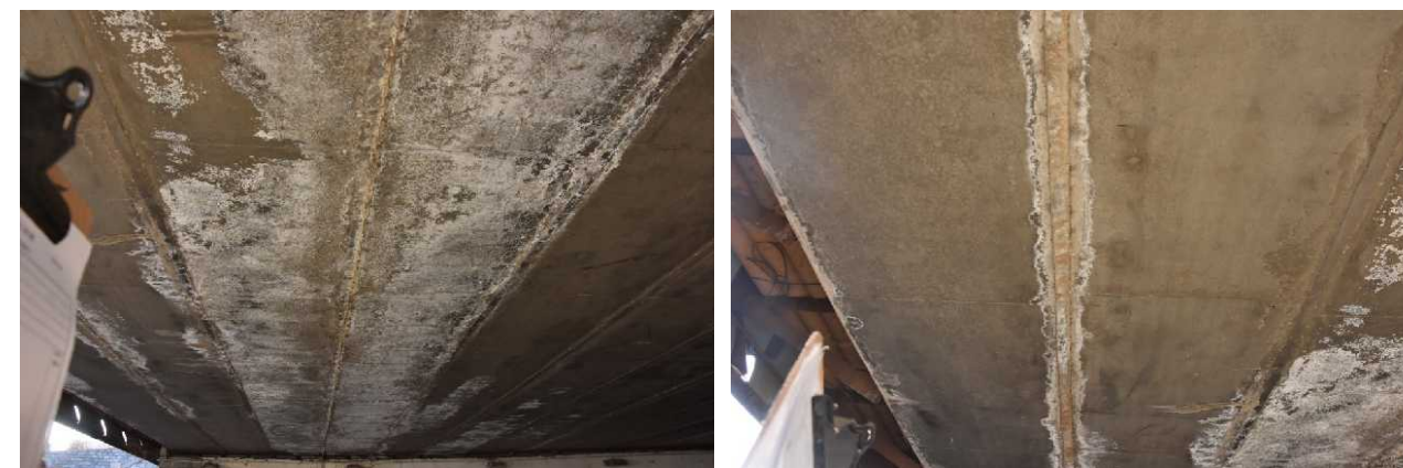
图 3.1.3 主梁梁间铰缝渗水典型照片
